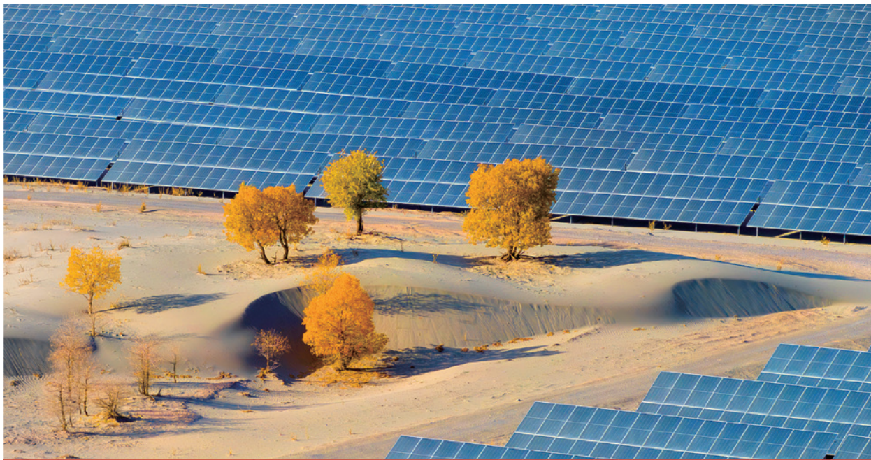
塔里木油田光伏产业蓬勃发展
