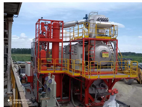
井场油基岩屑热脱附装置
