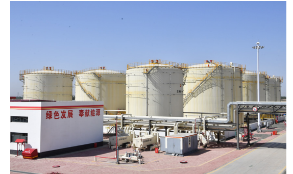
储罐 VOCs 回收装置
