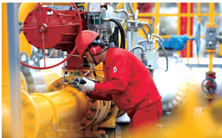
Работники газовой станции совершают обход маршрута
