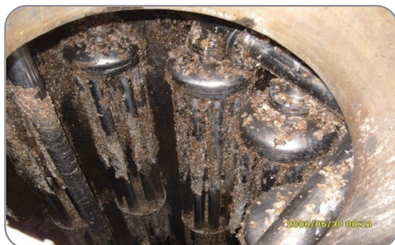
引进技术聚合釜运行 6 个月
