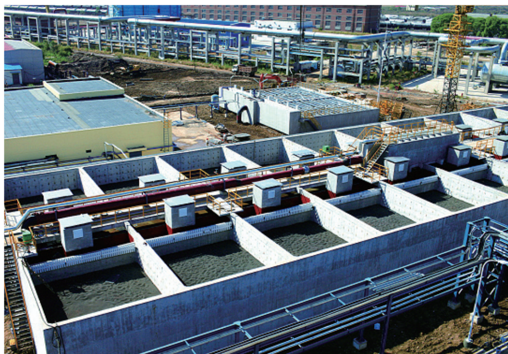
中国石油辽阳石化公司总排污水深度处理工程
