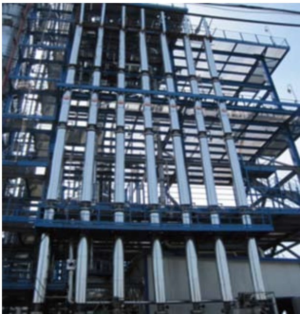
劣质重油改质油长周期储存稳定性管柱装置
