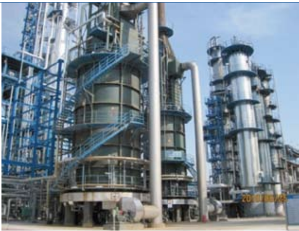
辽河石化 100 万吨 / 年沥青生产装置
