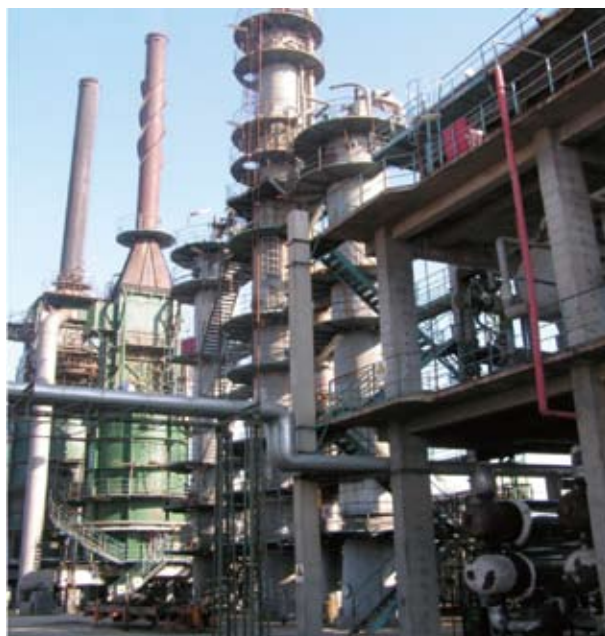
劣质重油供氢热裂化工业应用装置
