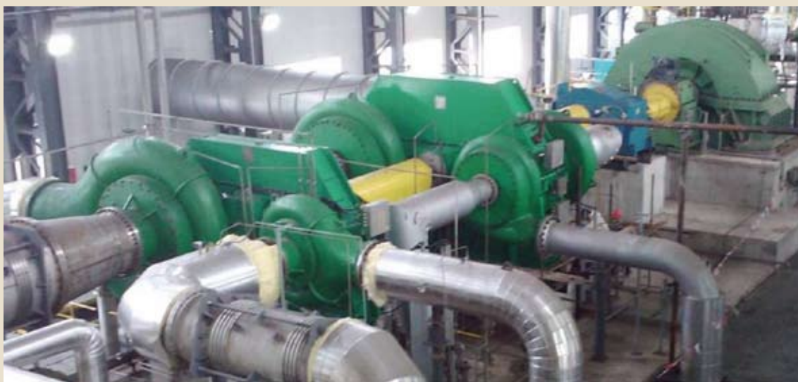
大型空压机组
