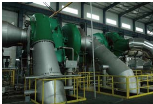
大型空压机机组
