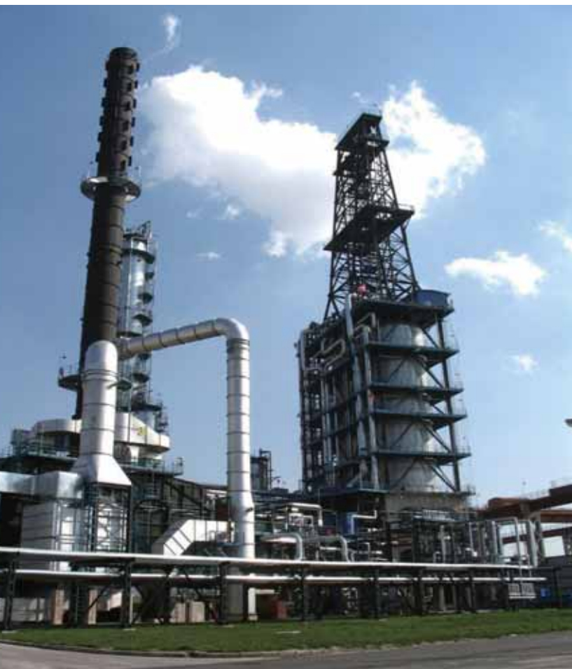
辽河石化委内瑞拉超重油渣油 100X10 4 t/a 延迟焦化装置
