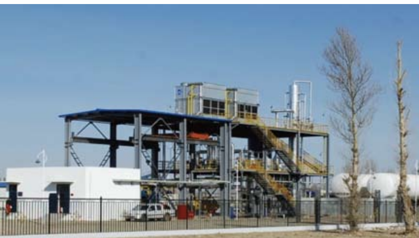
黑 59 液化注入站
