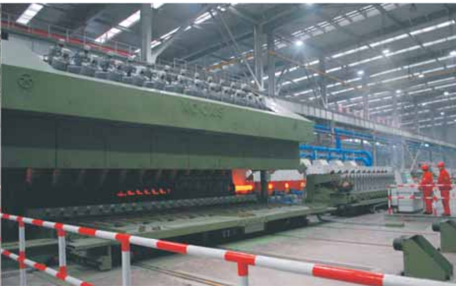
控制冷却设备
