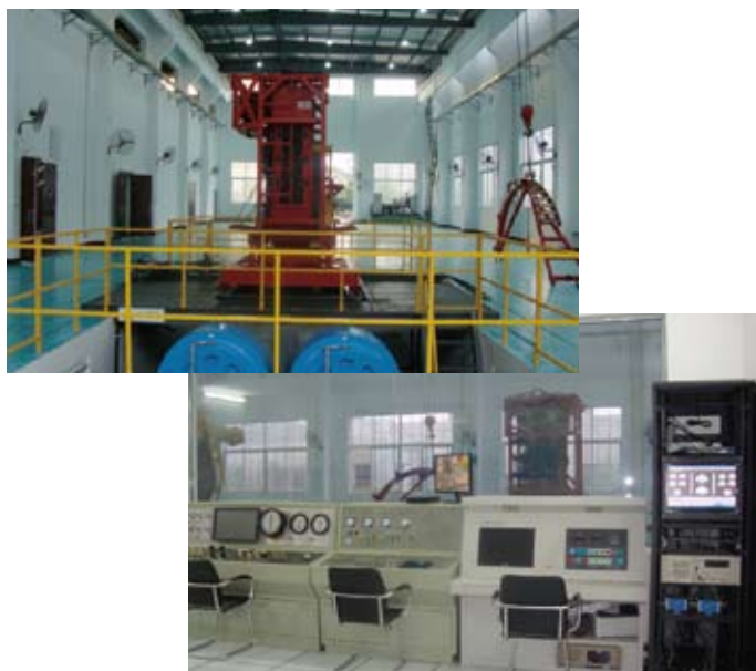
CNPC 钻井工程技术试验基地——连续管装备试验室
