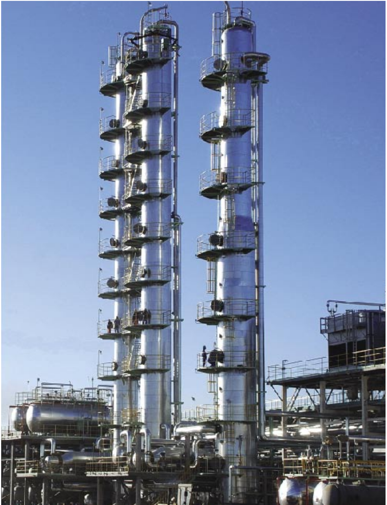
Unidad recogedora de hidrocarburo ligero en la Tercera Planta de Procesamiento de Crudo y Gas de Zhanazhol de la CNPC AktobetMunalGas.
