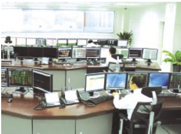
Cuarto de control central del Centro de Control de Petróleo y Gas en Beijing
