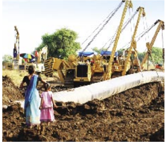
Proyecto de la tubería del envío del gas del este al oeste en la India
